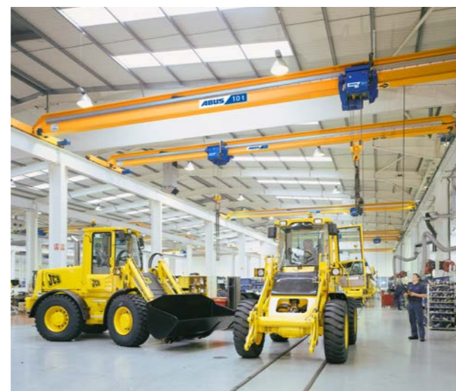
Enskinne løpekatt av typen E på ELV endrager traverskraner.
